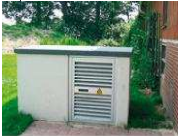
El.energijos pardavimas. Prieš parduodant el.energiją, ji tampa keičiama iš 400 V į 10 kV
