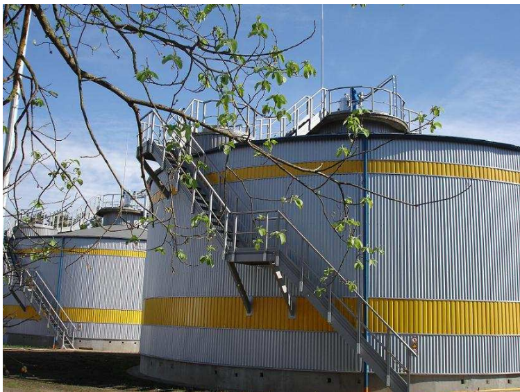
UAB „Aukštaitijos vandenys“ dumblo pūdytuvai po rekonstrukcijos
