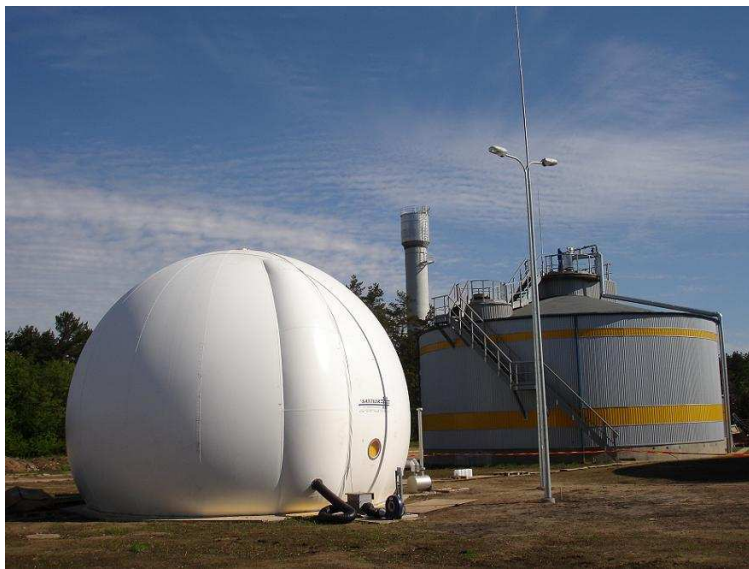
UAB „Aukštaitijos vandenys“ biodujų talpykla
