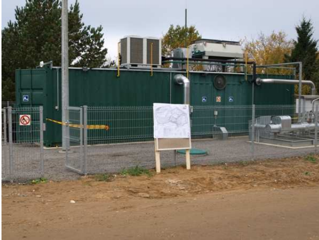
Kompresorinė šalia Lapių sąvartyno
