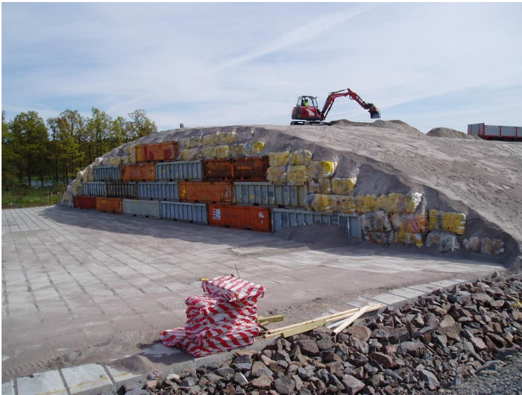
3.2-28 pav. LMRA atliekyno modulyje iš atliekų pakuočių sudaryta struktūra bei ją dengiančių apsauginių inžinerinių barjerų formavimas
